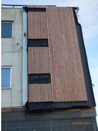
Figura 13. Módulo de instalaciones con registros abiertos
