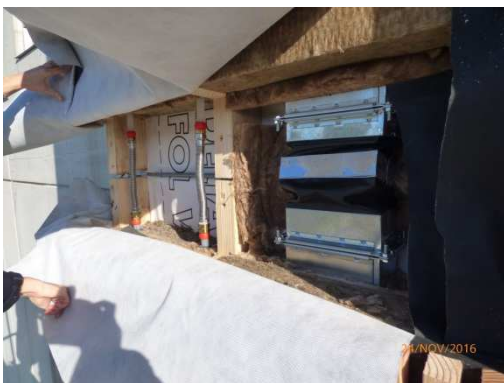
Figura 10. Registro entre paneles de instalaciones
