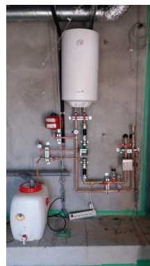
Figura 11. Instalación interior de ACS
